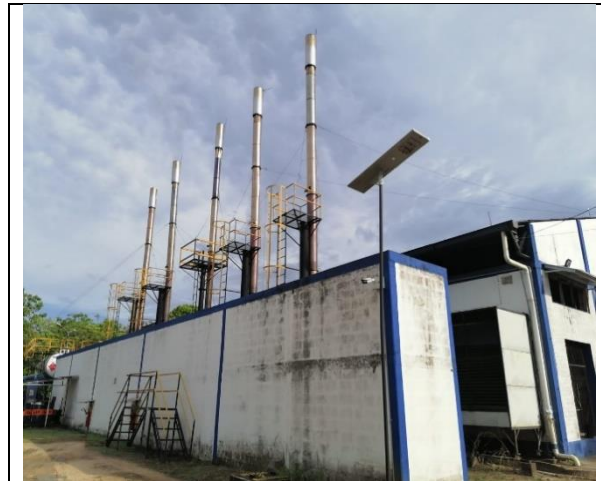
Posible alteración a la calidad del aire por actividades de generación de energía eléctrica
