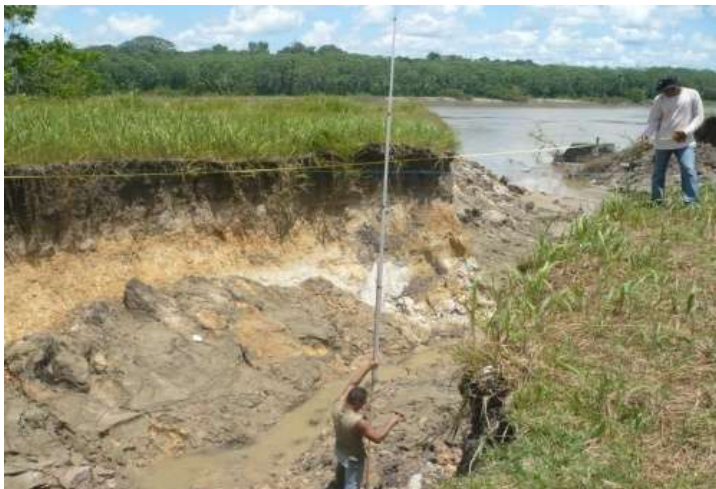
Levantamiento Cárcava No.3 ( sector de la Armada )
