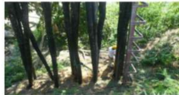
Foto No. 6. Hincada de pilotes en madera cárcava No. 2. Resguardo de Minlas.
