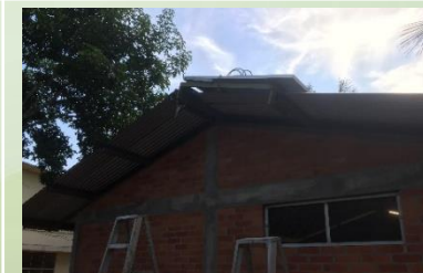
Instalación Panel Solar Institución Los Libertadores Inírida, Guainía.
