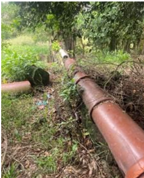
Imagen No.13 Vertimiento – descarga rota - en caño motobomba
