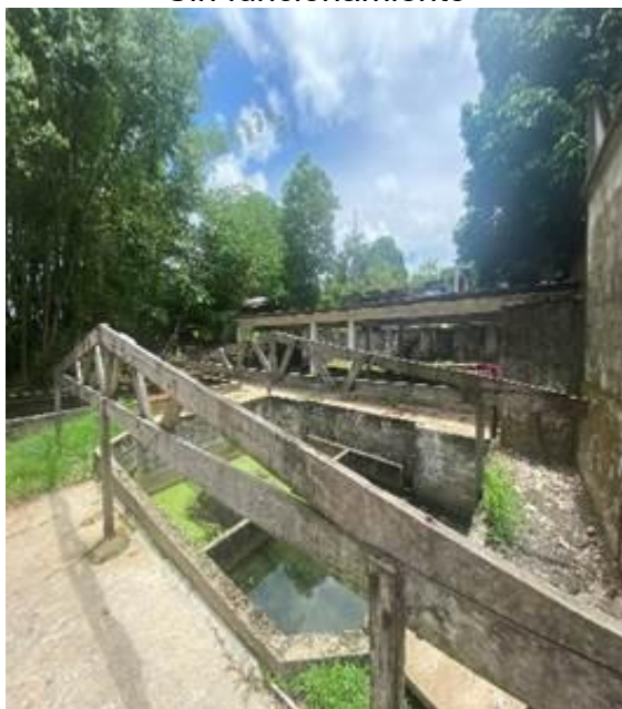
Imagen No. 11 Sin funcionamiento
