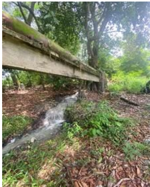
Imagen No. 14 Vertimiento – descarga rota - en caño motobomba
