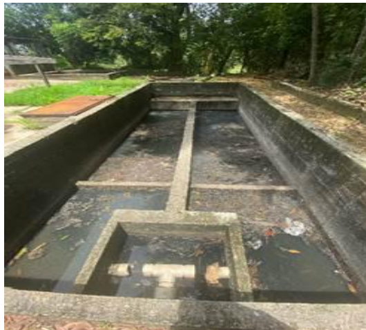
Imagen No. 10 Reactor - sin funcionamiento
