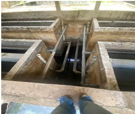
Imagen No. 9 Desarenador – sin funcionamiento
