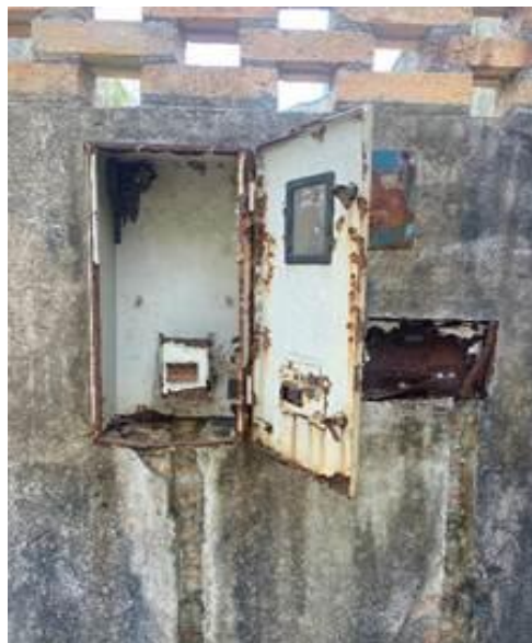
Imagen No. 16 Tablero zona caseta
