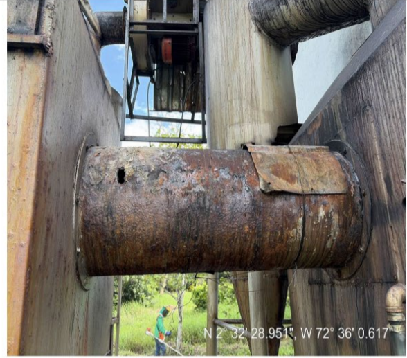
Imagen 2: Orificios en la estructura
